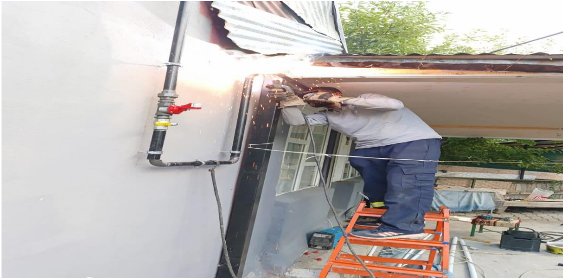
Şekil 1.7. Doğalgaz Tesisat İşleminde Uygun Olmayan Çalışma Örneği (Tunç, 2024)
