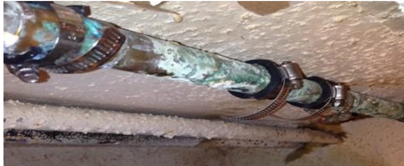
Şekil 1.5. Erozyon korozyonuna uğramış su borusu (URL-5 2018)
