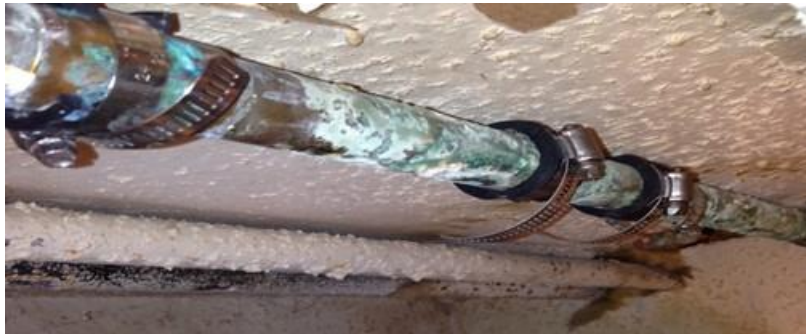
Şekil 1.6. Çukurcuk korozyonuna uğramış metal yüzeyi (URL-6 2018)
