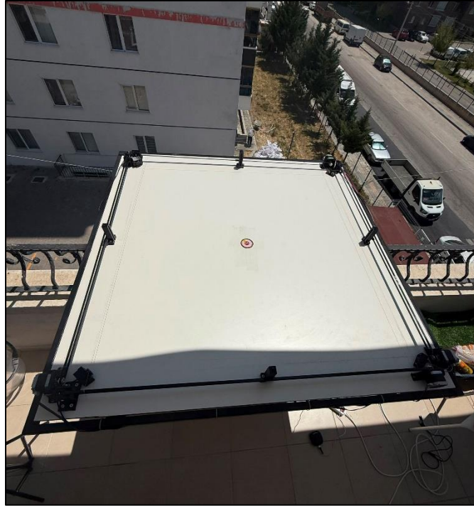
Şekil 3.11. Balkona kurulan platform güneş enerjisi destekli otonom İHA şarj istasyonunun verici (TX) biriminin gerçek uygulama görünümü
