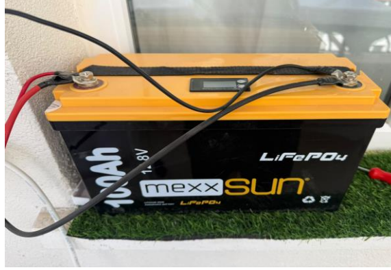
Şekil 3.16. Montajı yapılan 12 V 100 Ah LiFePO 4 (Lityum Demir Fosfat) akü
