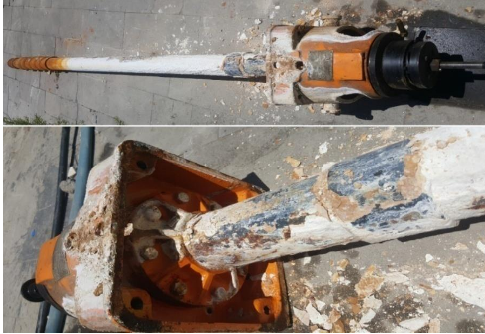
Şekil 1.9. Dikey milli pompada oluşan kabuklaşma ve aşınma sorunu
