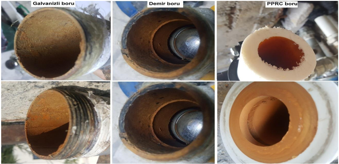
Şekil 2.26. Farklı tip borularda oluşan kabuklaşma
