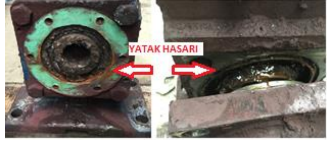
Şekil 4. Duşlu masa rollerinde hasarlı yatakların görünümü
