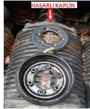
Şekil 5. Roll kaplin hasarı
