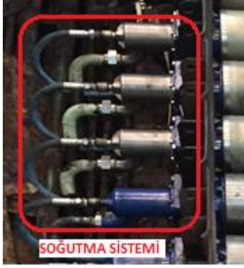
Şekil 6. Duşlu masa rollerinin içten soğutma sistemi
