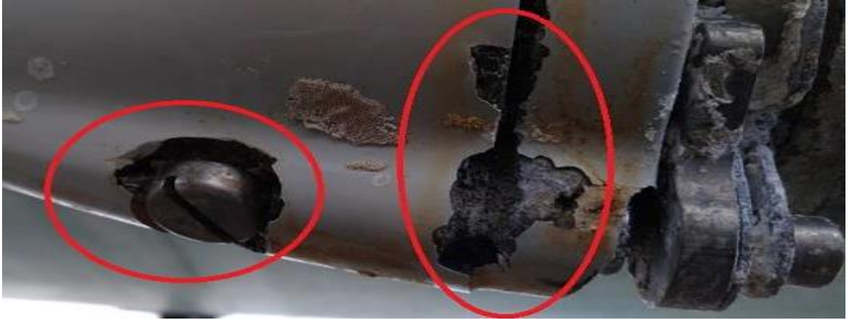
Şekil 1.2. Metalik eşleşmeler sonucu oluşan galvanik korozyon (URL-2 2021)
