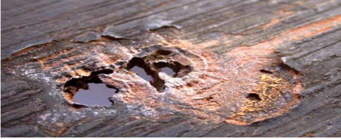
Şekil 1.7. Biyolojik korozyona uğramış su deposu (URL-3 2021)
