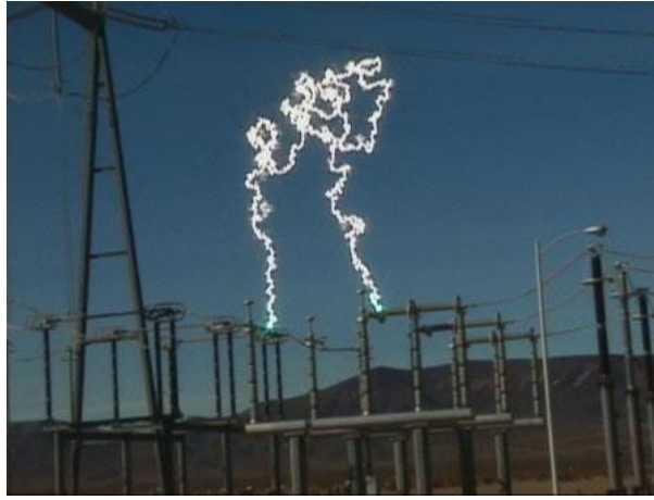
Şekil 1.15. Nevada, Boulder City'de 500 kV Eldorado trafo merkezi bakım yetkilisi Neil Brady tarafından çekilen videodan bir resim karesi (URL-22, 2022)
