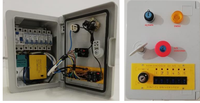
Şekil 3.11. Elektrik panosu görünüşü
