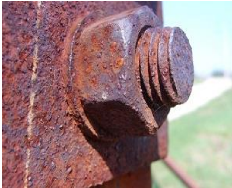
Şekil 1.1. Homojen korozyona uğramış somon+ vida (URL-2, 2009)
