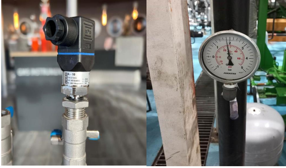
Şekil 6.3. Basınç transmitteri ve manometre
