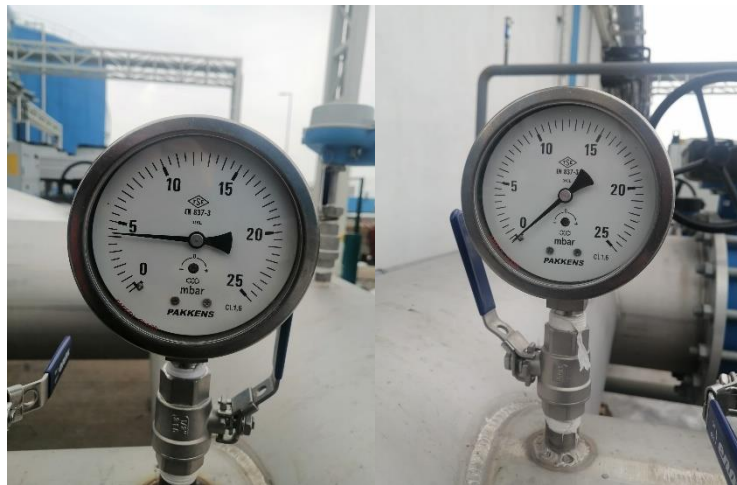
Şekil 6.49. Biyogazın gaz soğutma eşanjörüne giriş ve çıkış basıncı
