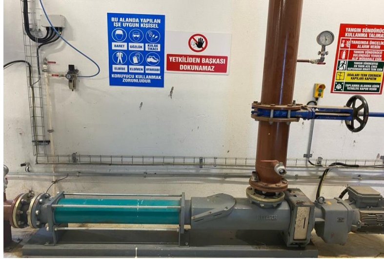
Şekil 6.30. Atık besleme mono pompası
