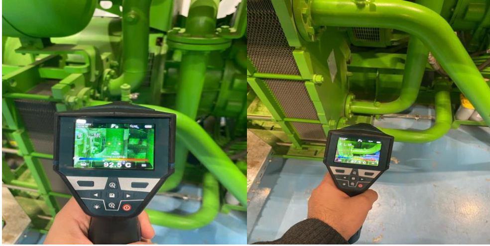
Şekil 6.46. Ceket suyu motor çıkışı ve motor dönüş sıcaklığı
