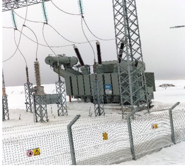
Şekil 4.28. Trafo köşkünde bulunan parafudr
