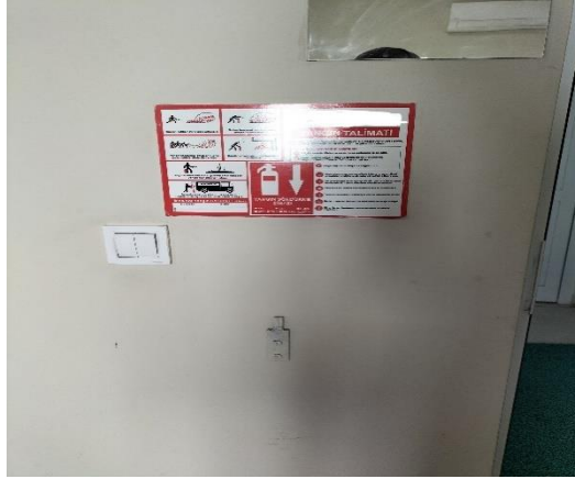
Şekil 4.21. Mutfak yangın söndürme tüpü
