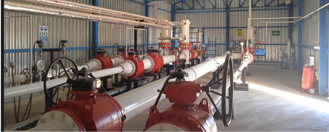
Şekil 4.12. RMS-A doğalgaz istasyonu
