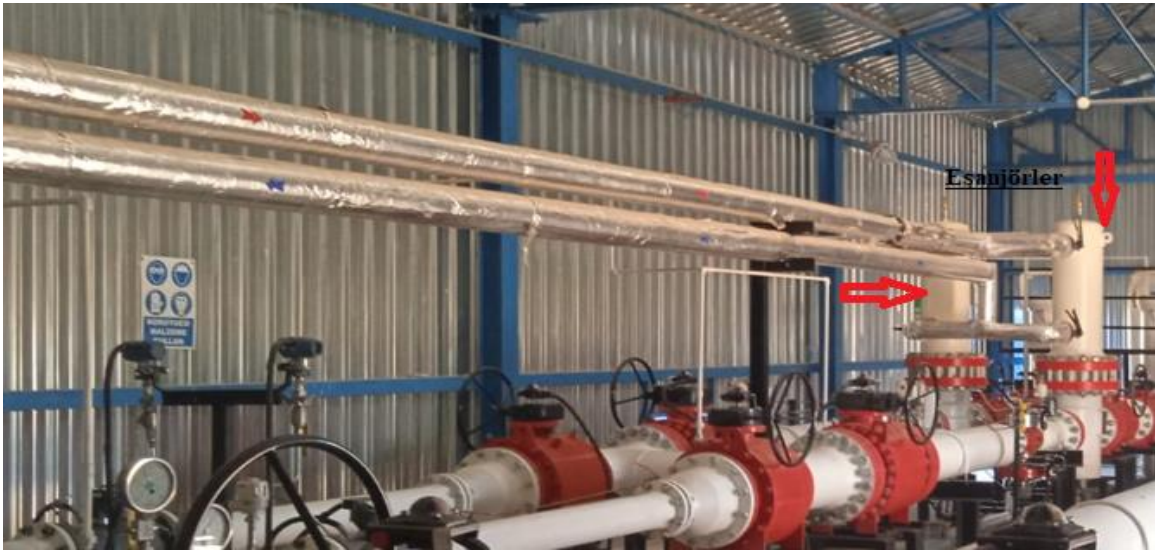
Şekil 4.16. RMS-A doğalgaz ısıtma eşanjörleri, gidiş-dönüş su boruları
