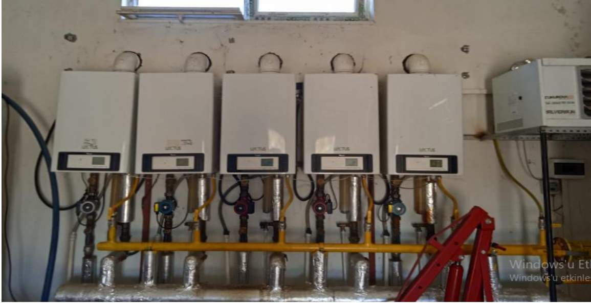
Şekil 4.15. Bingöl merkez RMS-A doğalgaz ısıtma kaskad sistemi
