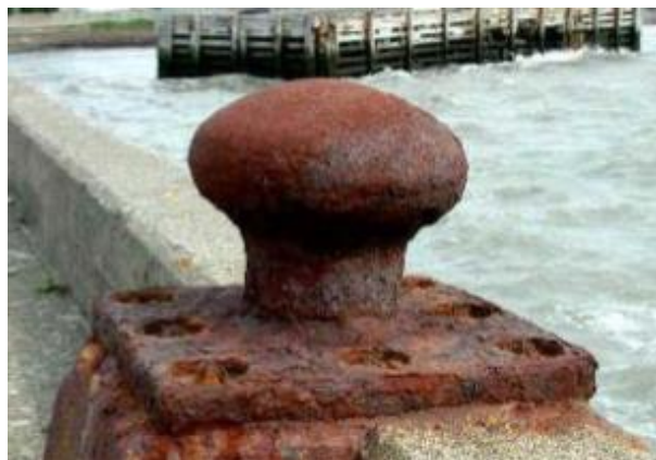
Şekil 1.1. Homojen korozyona uğramış metal (URL-1 2017)
