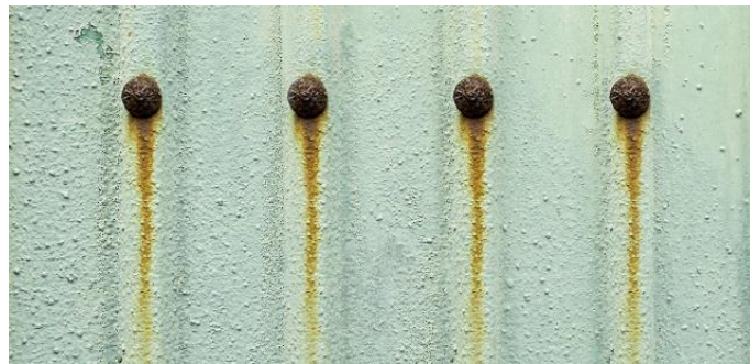
Şekil 1.6. Galvanik korozyona uğrayan demir cıvatalar (URL-6 2017)
